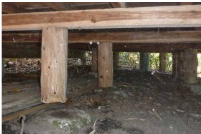
相当に痛んでいるロッジの下まわり
